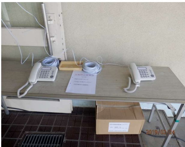
体育館に設置した災害時の非常公衆電話
